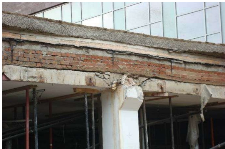
Рис. 4. Плита покрытия стилобата после разрушения
